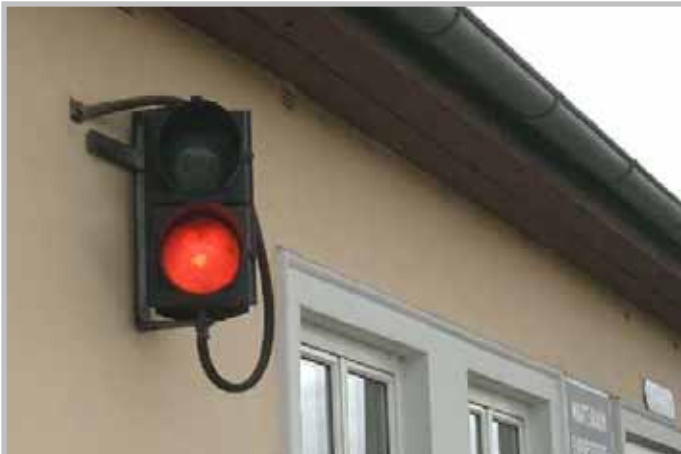
Foto oben: 14. Juli 2005, 8.48 Uhr: Nur noch wenige Minuten, dann ist der „Spezial“-Signalnachahmer am Aufnahmsgebäude Geschichte. Weiters sind zwei weitere GKB-Besonderheiten dem ESTW zum „Opfer“ gefallen. Die Vorsignale mit jeweils nur einer Gelb- und Grünlichtlampe sowie die „EK-Kontrolllichter“ der EK in km 1,837 (Wetzelsdorfer Straße).
